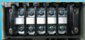
AC(交流) 電壓端子
